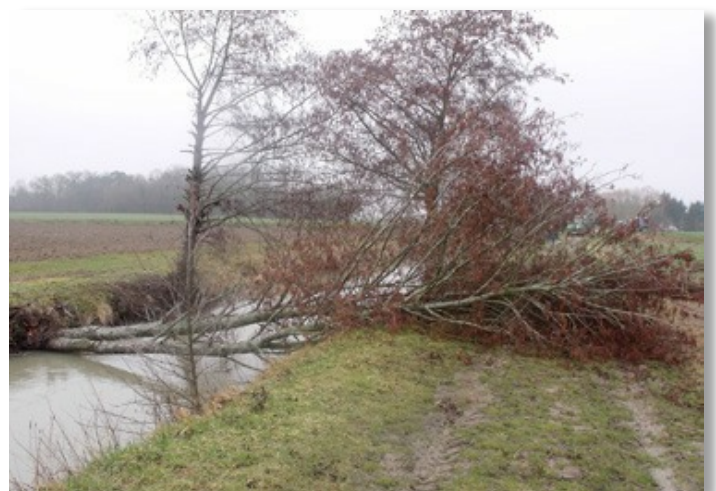
EMBÂCLES À SUPPRIMER
